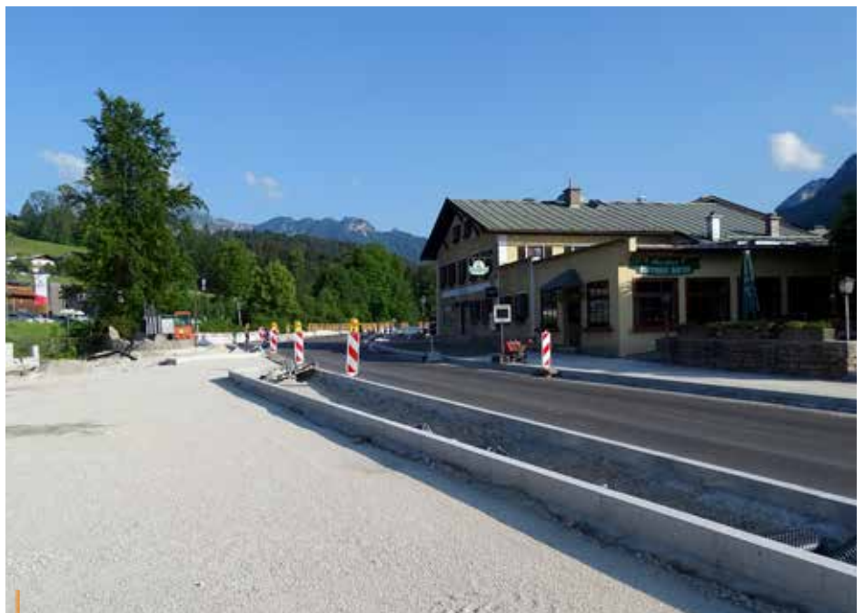
Dieser Anblick gehört der Vergangenheit an. Nun ist wieder eine ungehinderte Ortsdurchfahrt möglich.
