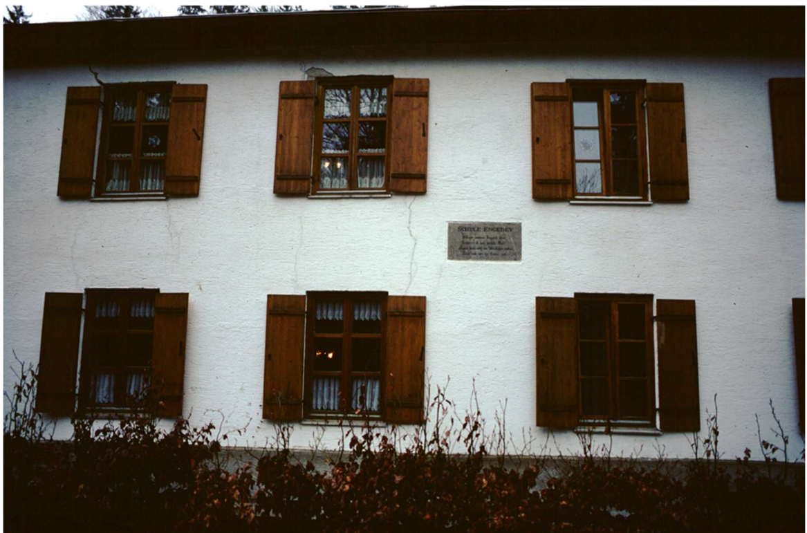
Abbildung 6: Setzungsrisse ehemaliges Schulhaus Engedey Foto von 2004
