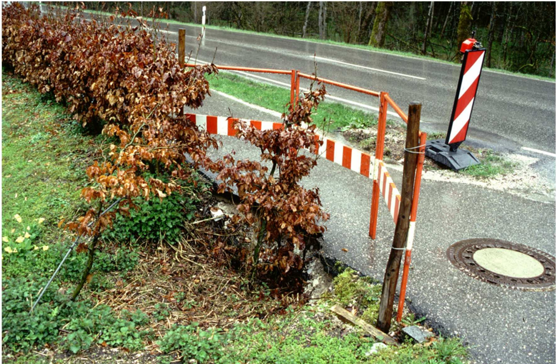
Abbildung 7: Erdfall an B 305 ehemalige Schulhaus Engedey Jahr 2016
