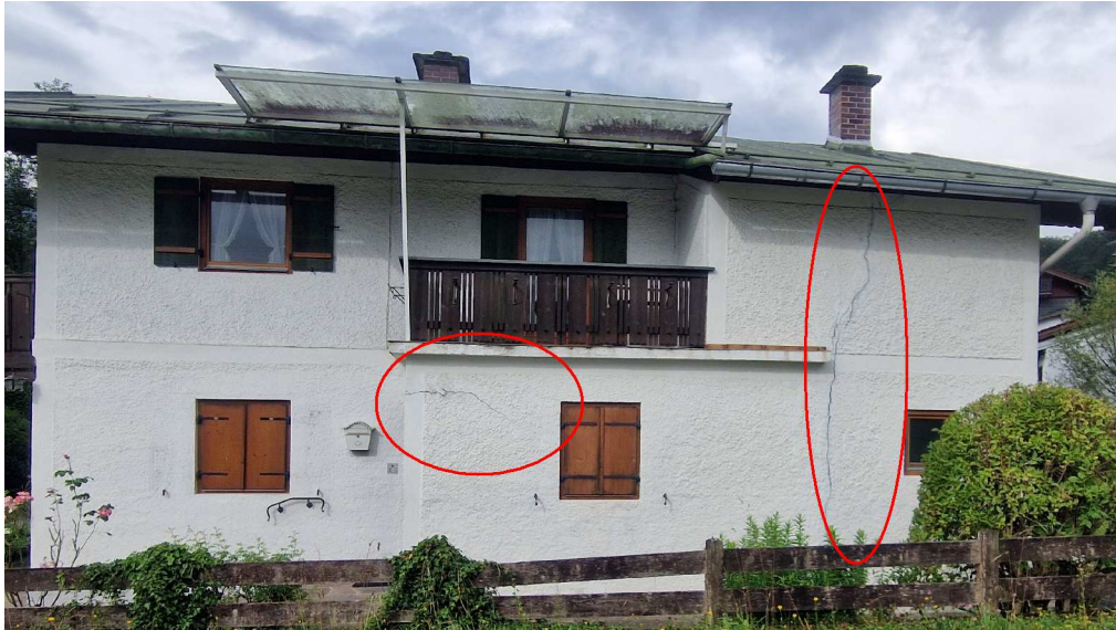
Abbildung 11: Rissbild Haus Nr. 50 Stangerriegel
